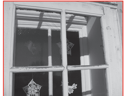
Okna v Bukovanech čekají na svou rekonstrukci
